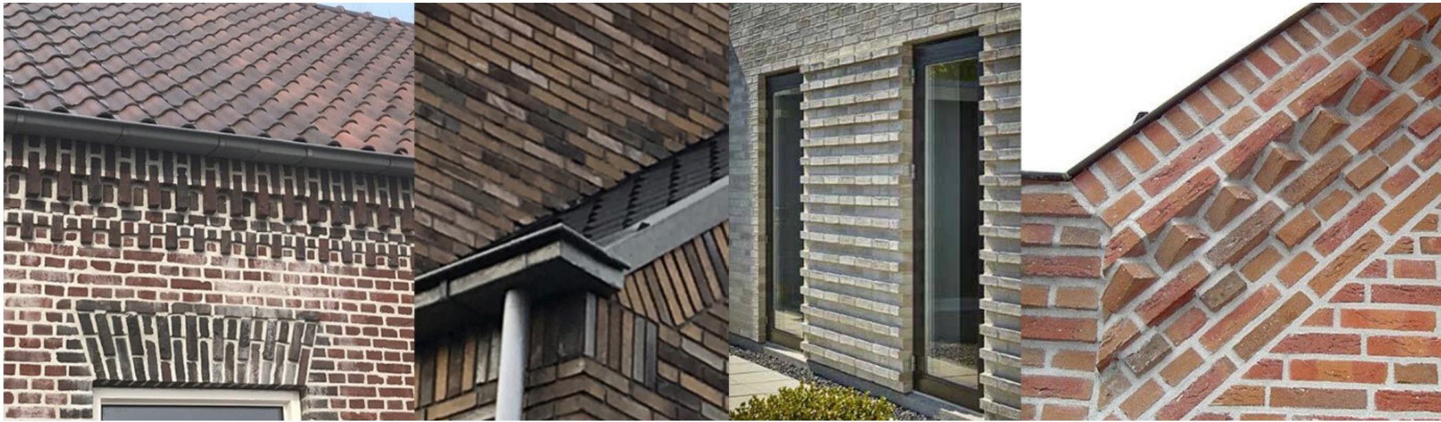
Figuur 13 Verbijzonderingen in het metselwerk
